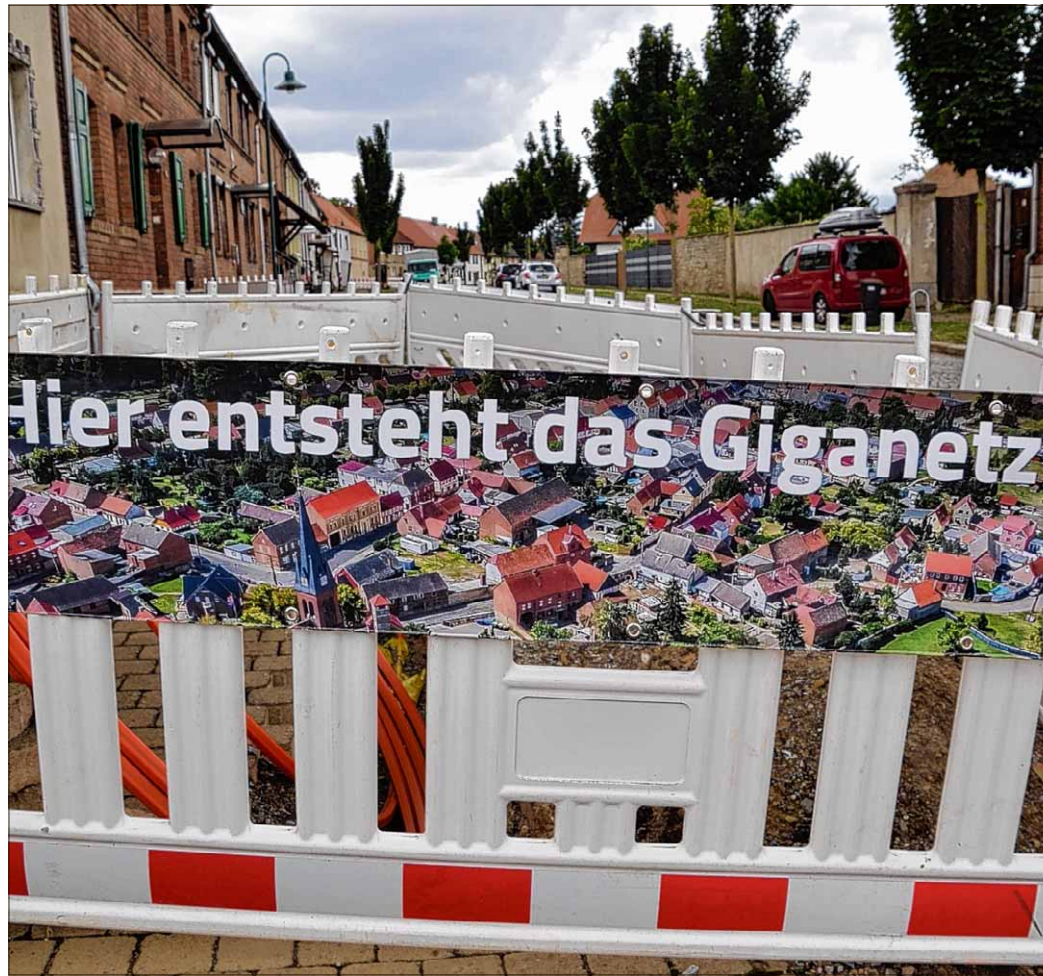
Von Wulferstedt aus startete der Breitbandausbau in der Gemeinde Westliche Börde. Aktuell sind die Tiefbauarbeiten ins Stocken geraten.
