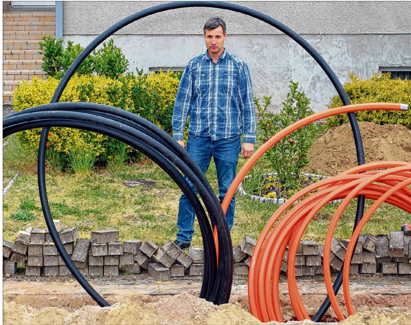
Der Breitbandausbau schreitet in Sandbeiendorf voran. Carsten Miehe, Bürgermeister der Gemeinde Burgstall, überzeugt sich täglich über die Baufortschritte. „Es geht zügig voran“, zeigt er sich beeindruckt.
